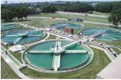
تصفیه آب در تصفیه خانه
