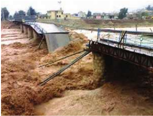
تخریب پل در اثر سیلاب منطقه تنگ کینشت، استان کرمانشاه
