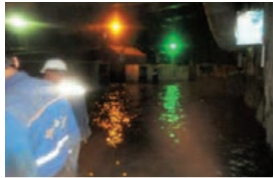
شکل ۱۰-۶ هجوم آب، گل و لای در زمان حفاری تونل‌ها
