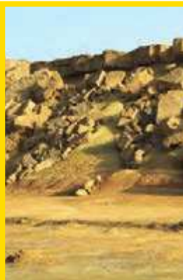
شکل ۱- الف) سنگ در حال تخریب
