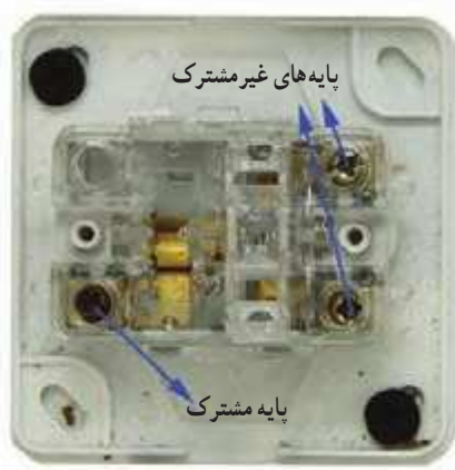
شکل ۱۹-۶- نمای داخلی یک نمونه کلید تبدیل
