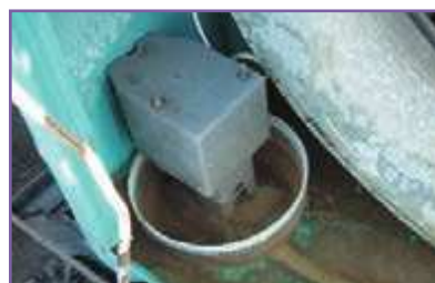
ج- بررسی و تمیز کردن پمپ آب
